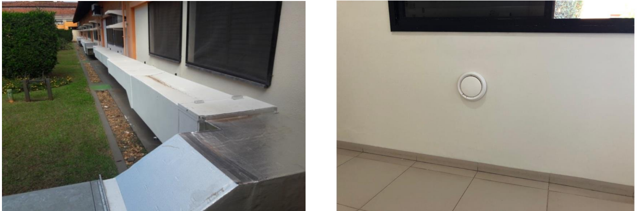
Figura 7 – Sistema de exaustão instalado na Unid. de Internação COVID-19
